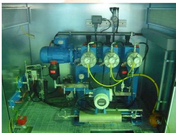
Pompa di alta pressione per dosaggio Pentano
