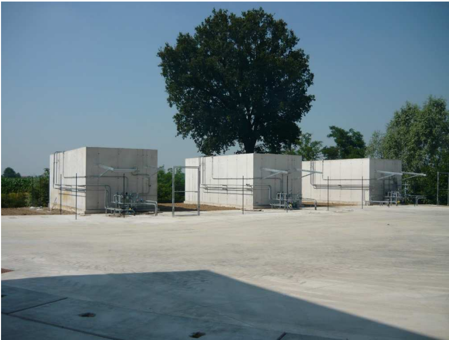
Serbatoi Tumulati per Gas Propellenti Butano/Propano-HFC-HFO
