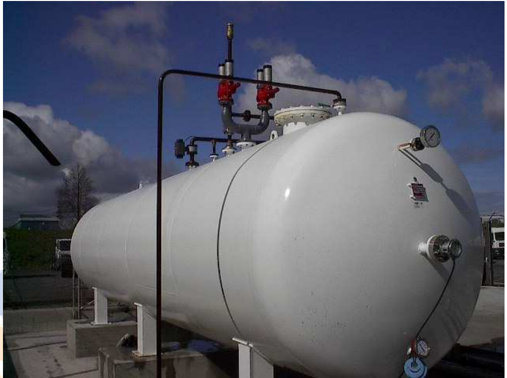
Serbatoi a vista per Gas Propellenti Butano/Propano-HFC-HFO
