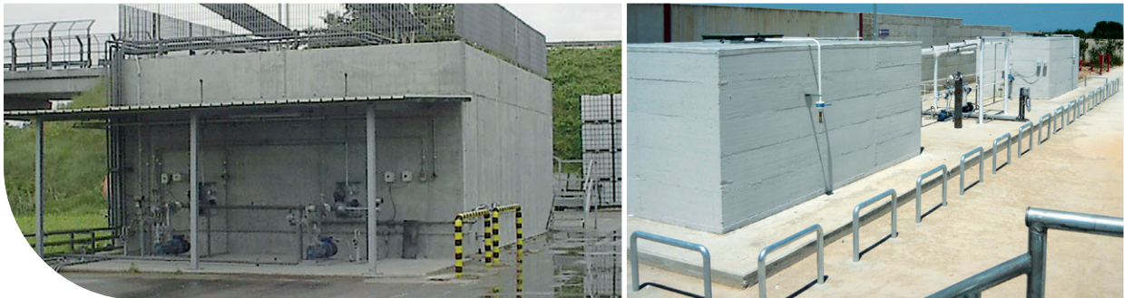
Serbatoio sopra suolo in box di cemento armato per gas espandenti infiammabili/non infiammabili. StorageTank above-ground in concrete box for blowing agent gases (flammable or not flammable).
