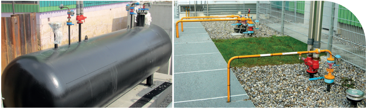
Serbatoio sotto suolo in box di cemento armato per gas espandenti infiammabili/non infiammabili. StorageTank under-ground in concrete box for blowing agent gases (flammable or not flammable).
