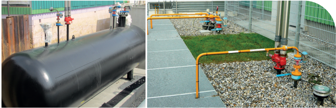
Serbatoio sotto suolo in box di cemento armato per Gas Refrigeranti infiammabili/non infiammabili.
