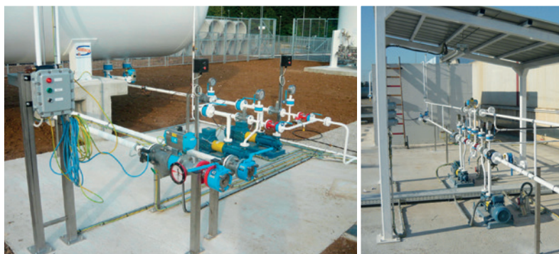
Gruppi pompe gas refrigerante alla produzione (bassa pressione).
