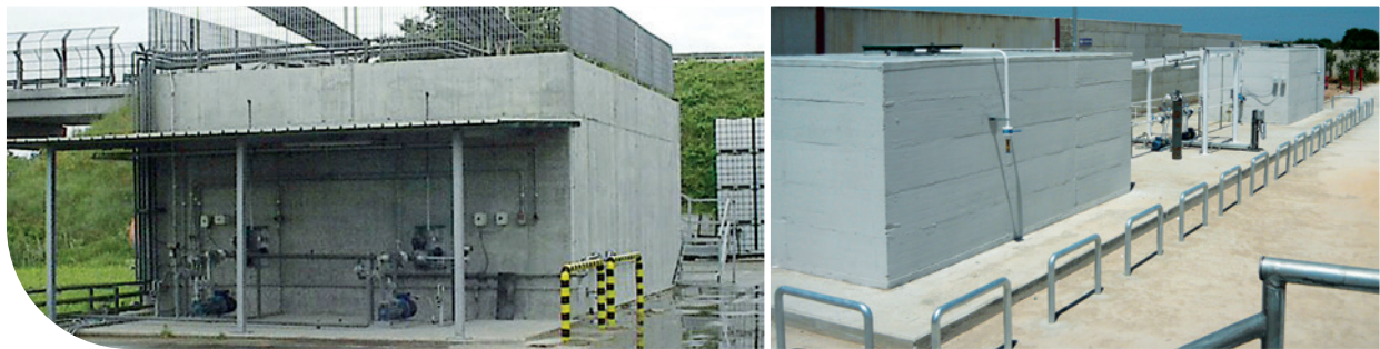
Serbatoio sopra suolo in box di cemento armato per Gas Refrigeranti infiammabili/non infiammabili.
